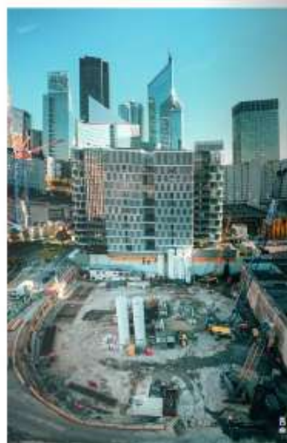
NGE Fondations participe à la réalisation des fondations du premier bâtiment à ossature bois de La Défense, des fondations bas-carbone.
